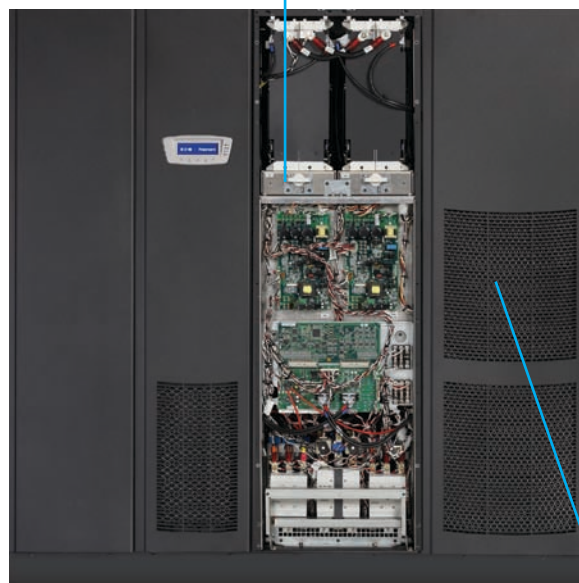
Wartung der Eaton 9395 550 kVA bei laufendem Betrieb
